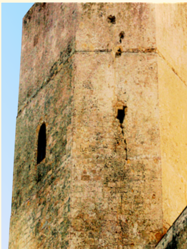
Particolare della torre ottagonale. La foto evidenzia la formazione di una pericolosa crepa in senso longitudinale.
